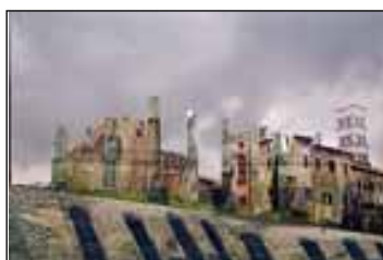
ELDŐLT A TÁMFAL / LEANING BUTTRESS
